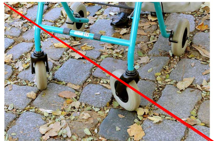
aus: Dokumentation Holperpflaster, 2011
