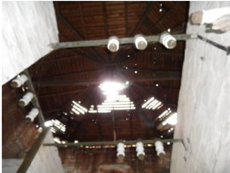
Foto 11: undichte Dachkonstruktion (bestehendes Notdach)
