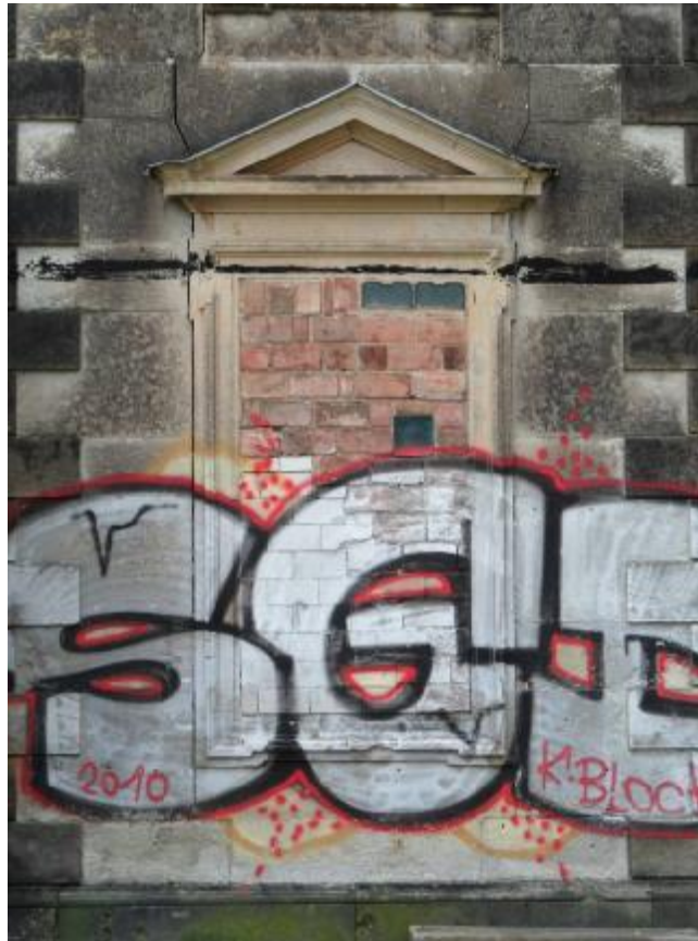
Foto 9: Verunreinigungen durch Graffiti
