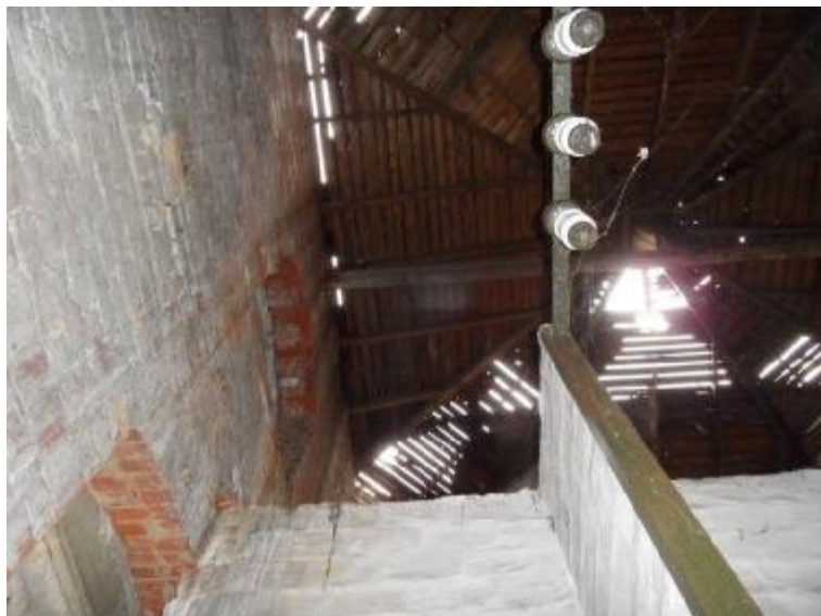
Foto 12: undichte Dachkonstruktion (bestehendes Notdach)
